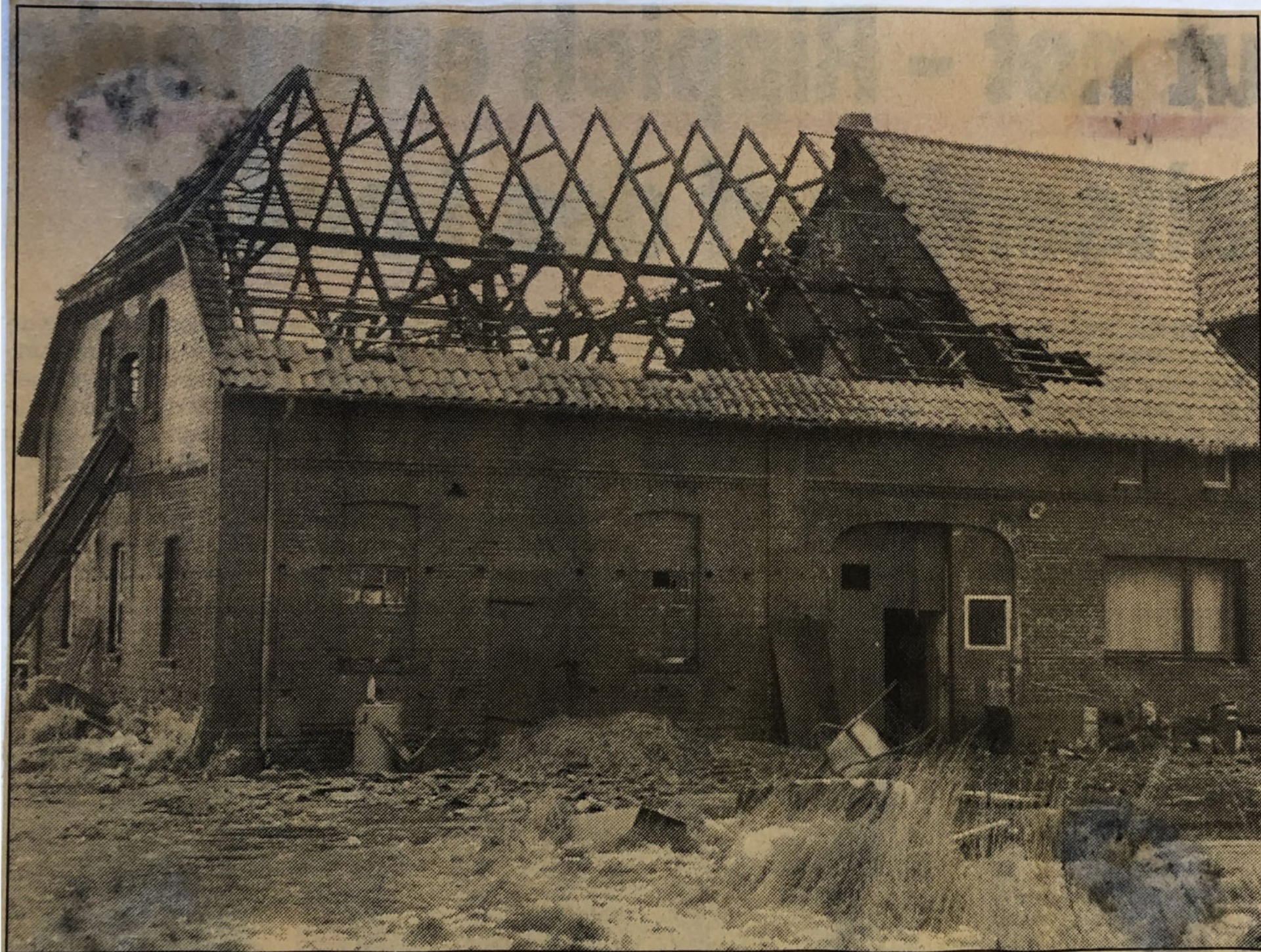
Das Stallgebäude der Blenderaner Mühle brannte in der Nacht zum vergangenen Sonntag beinahe völlig aus. 11.1.1995
