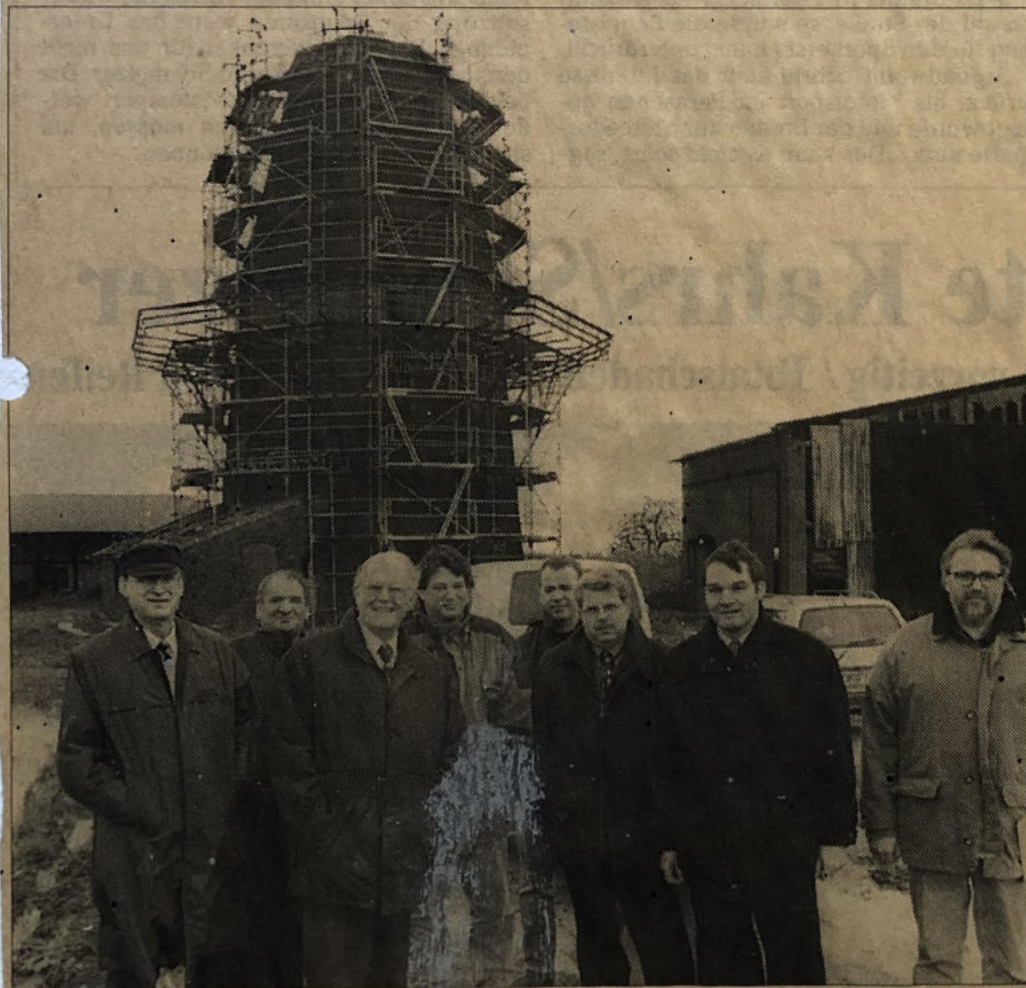
Unterhalb der komplett eingerüsteten Mühle gaben Vertreter des Landkreises, der Gemeinde Blender und des Förderkreises gestern den Startschuß für die Restaurierung. Foto: Manfred Below
