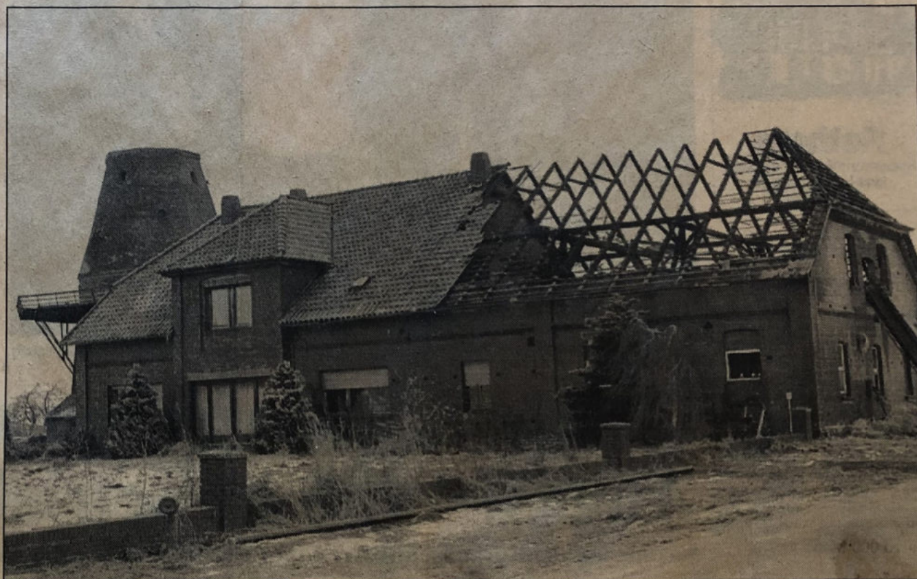
Rauchwolken stiegen auch gestern noch aus dem verkohlten Dachboden auf. In der Nacht gegen 2.20 Uhr war das Feuer in dem Stalltrakt des Gebäudes neben der Blender Mühle ausgebrochen. Unter dringendem Tatverdacht der Brandstiftung steht der ehemalige Besitzer.
