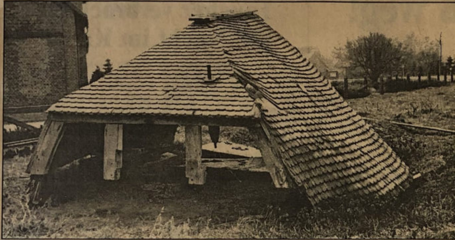
Das Dach der Mühle wurde abgebaut, der Mühlensumpf aber nach dem Entfernen der Kappe nicht abgedichtet. Nässe gelangte zwangsläufig ins Mauerwerk.
