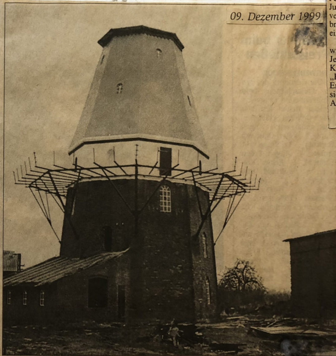
Endlich ist das hässliche Gerüst weg. Man sieht der Blender Mühle schon jetzt an, dass sie nach abgeschlossener Sanierung einmal zu einem Schmuckstück werden könnte. 9.12.99 Foto: Sperlin
